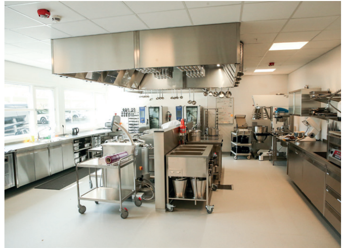
Hovedkjøkkenet ligger i underetasjen i bygg D der det er hovedinngang, dagsenter og administrasjon over.
