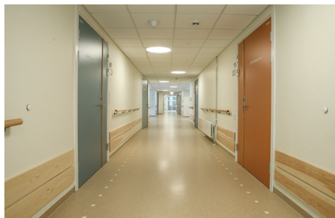
Dette gangarealet har systemhimling i tak, vinylbelegg på gulv, og malt gips på vegger med trelister som påkjøringsvern på nedre del.
